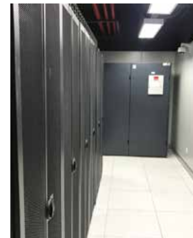
上金所建设的节能型机房和机柜。
